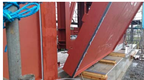
パネル開放状況(パネル下部)
