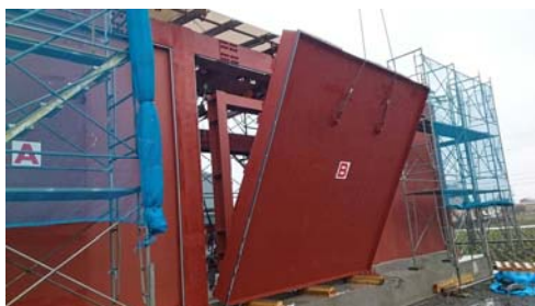
パネル開放状況
