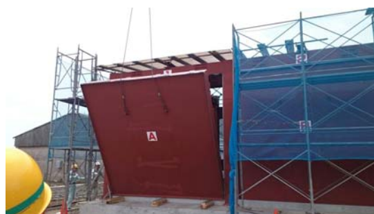
パネル開放状況
