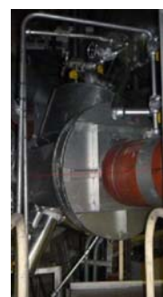
通路上部の電動弁
