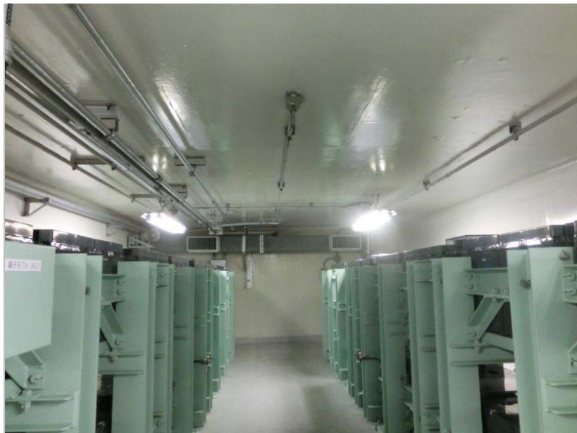
第 1-43 図 蓄電池の設置状況
