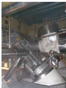
主蒸気隔離弁
