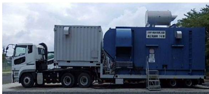
常設代替交流電源設備
