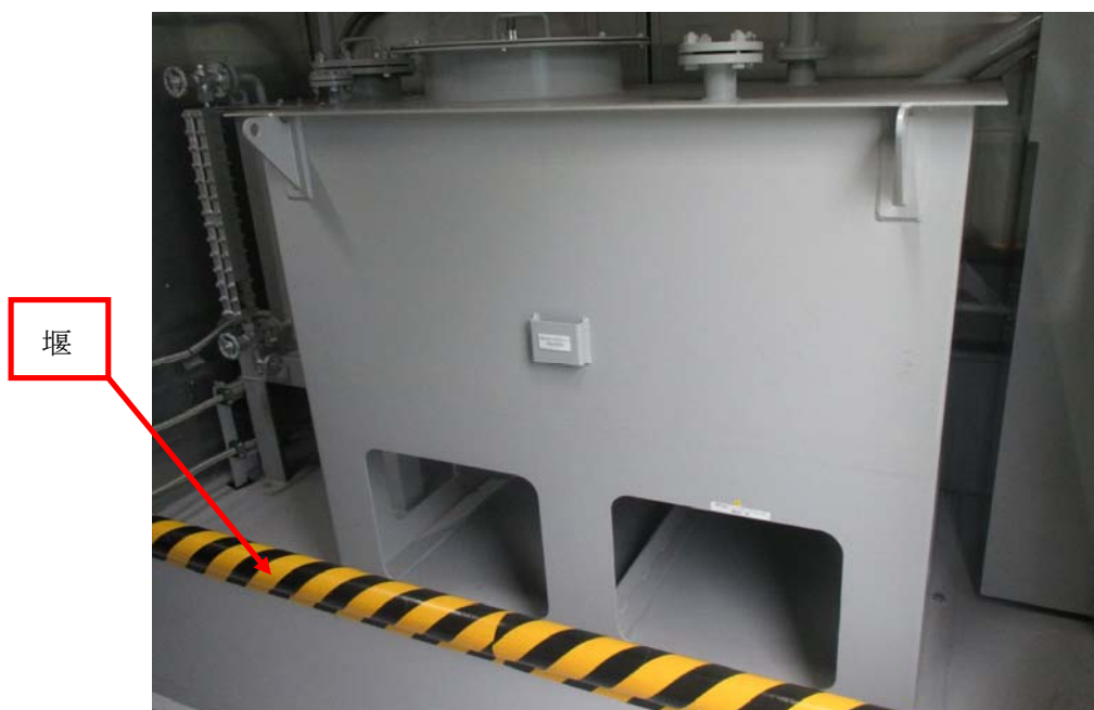
第 1 図 常設代替高圧電源装置燃料油サービスタンクの堰
