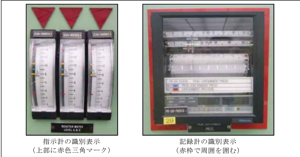
第 2.1-6 図 重要指示計等の識別表示 (例)
