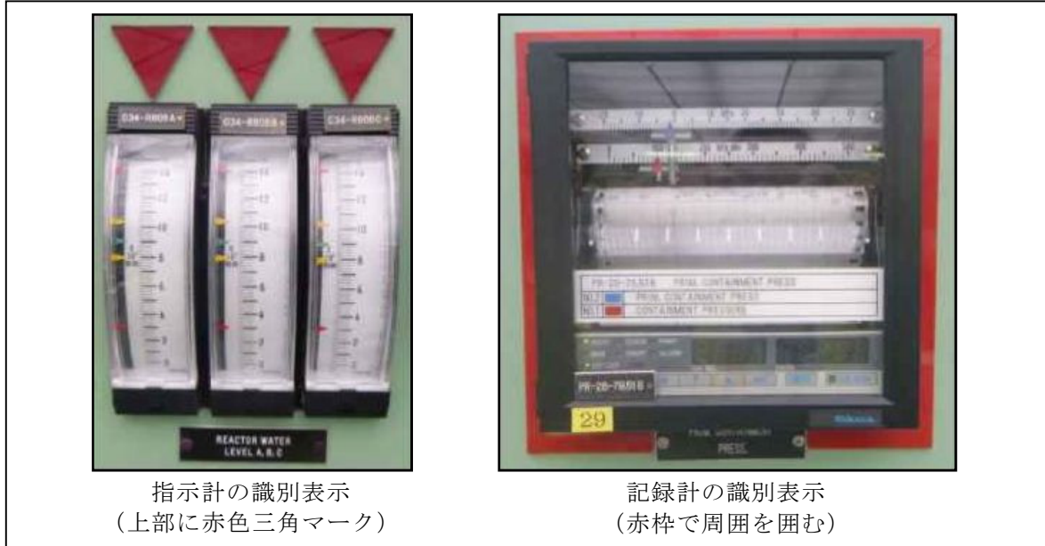
第 2.1-6 図 重要指示計等の識別表示 (例)
