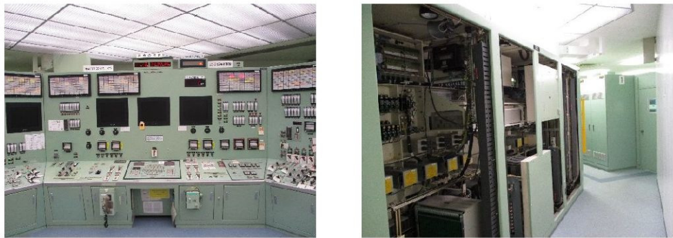
図3 原子炉制御盤（換気口無し）
