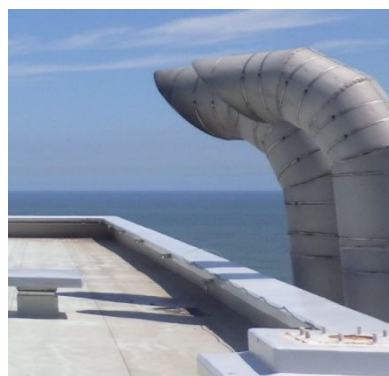
図 2-6 ディーゼル発電機 排気管
