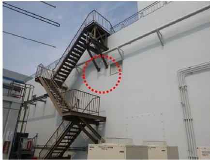
図2 外気取入口（中央制御室換気空調系）
