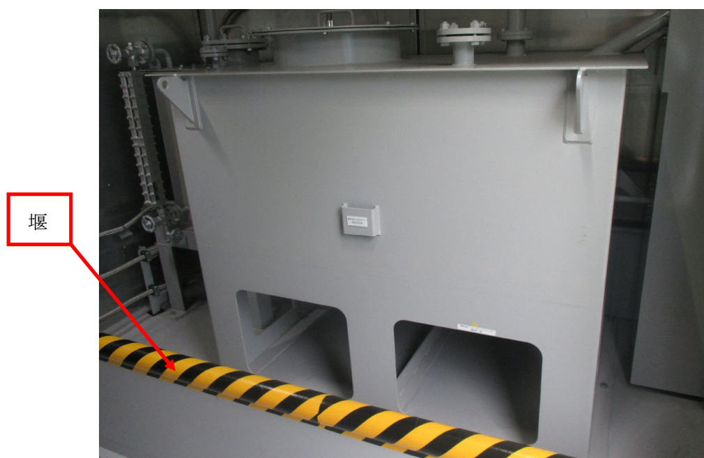
第 1 図 常設代替高圧電源装置燃料油サービスタンクの堰
