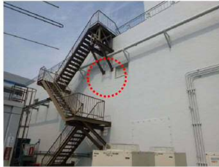
図2 外気取入口（中央制御室換気空調系）
