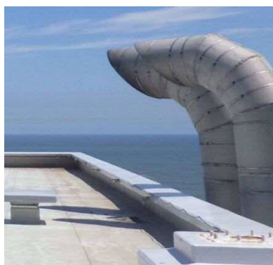
図 2-6 ディーゼル発電機 排気管
