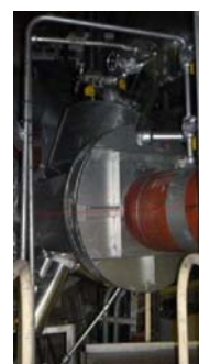
通路上部の電動弁
