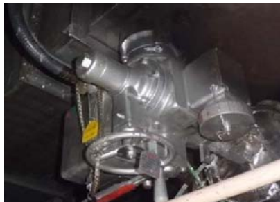
通路上部の電動弁
