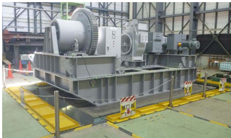
第9図 開閉装置の試験装置（全景）
