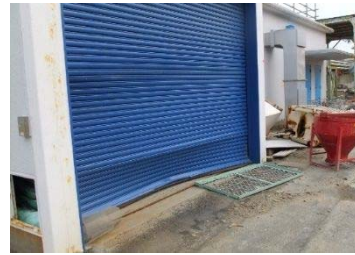
② メンテナンスセンター（S造） シャッター変形
