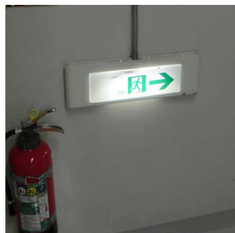
通路誘導灯（廊下・通路）
