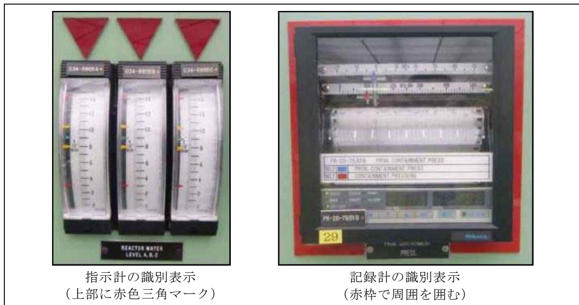
第 2.4.1-6 図 重要指示計等の識別表示（例）
