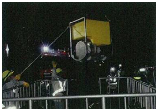
夜間での送水訓練（ポンプ設置）
