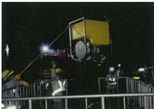
夜間での送水訓練（ポンプ設置）
