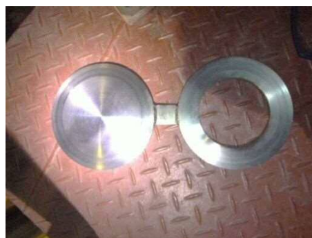
連絡配管閉止フランジ
