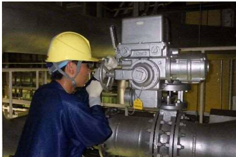
耐圧強化ベント現場操作
