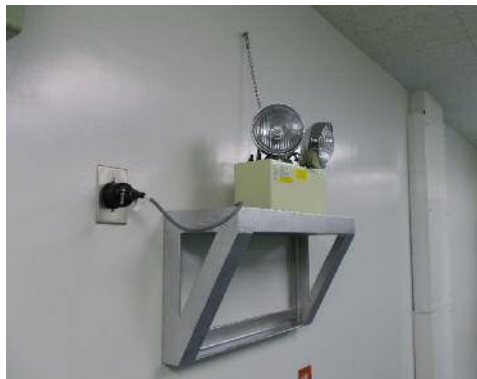
第 1.0.13-6 図 蓄電池内蔵型照明の例
