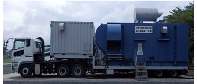
常設代替交流電源装置
