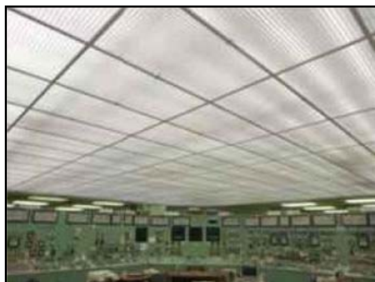
（通常点灯状態）
