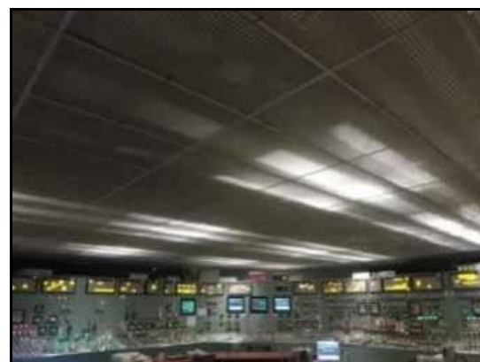
（直流非常灯点灯状態）
