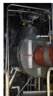
通路上部の電動弁
