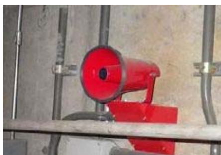
退避サイレン用音響装置
