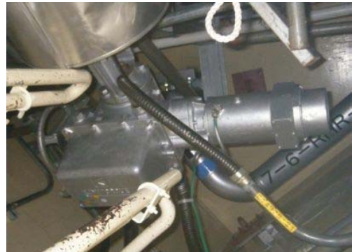
通路部上部の電動弁，電線管他
