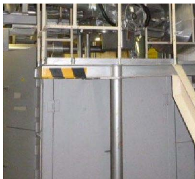
電動弁(遮蔽内に設置)
