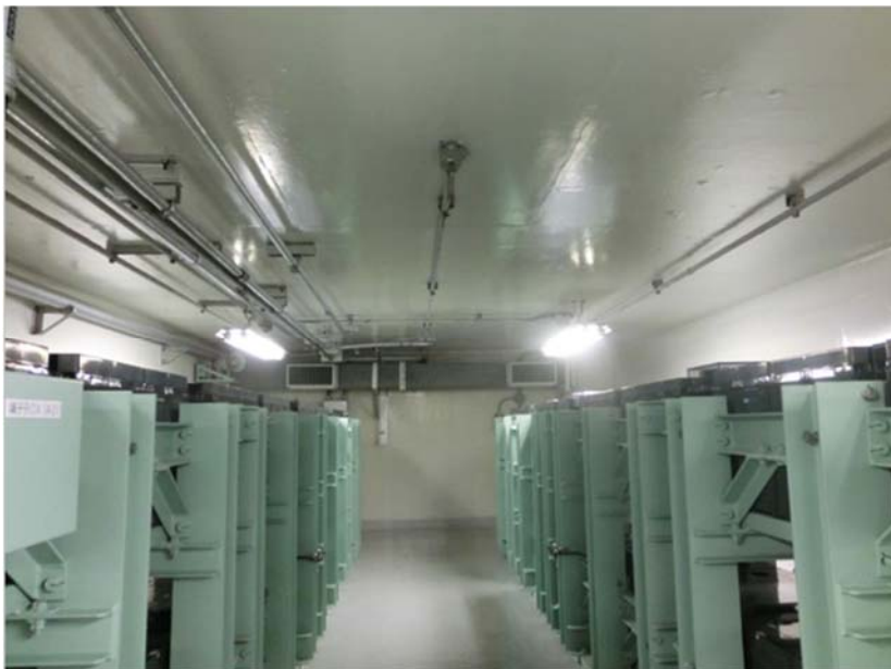
第41-1-41図 蓄電池の設置状況
