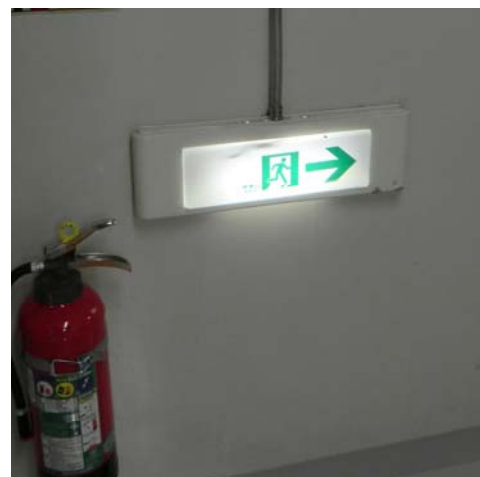
通路誘導灯（廊下・通路）
