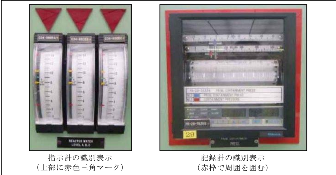
第 2.4.1-6 図 重要指示計等の識別表示 (例)
