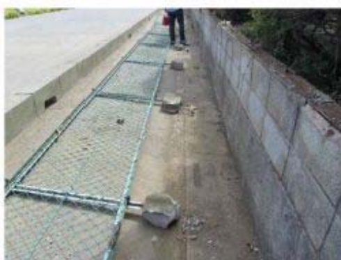
フェンスの倒壊
