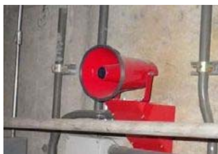
退避サイレン用音響装置
