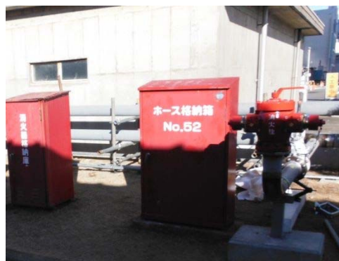
#153 消火設備格納箱
