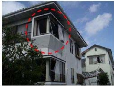
出窓部の窓ガラスの損壊
