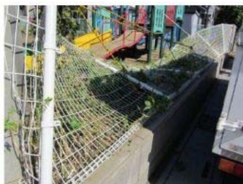
フェンスの変形
