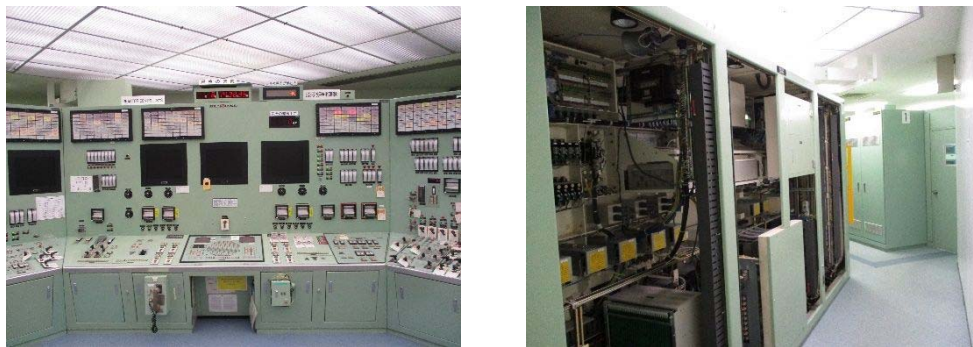
第3図 原子炉制御盤（換気口無し）
