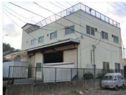
屋上フェンスの変形
