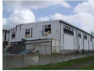
窓ガラスの損壊
