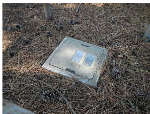
#418 コンクリート製蓋
