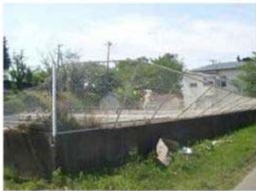
フェンスの変形
