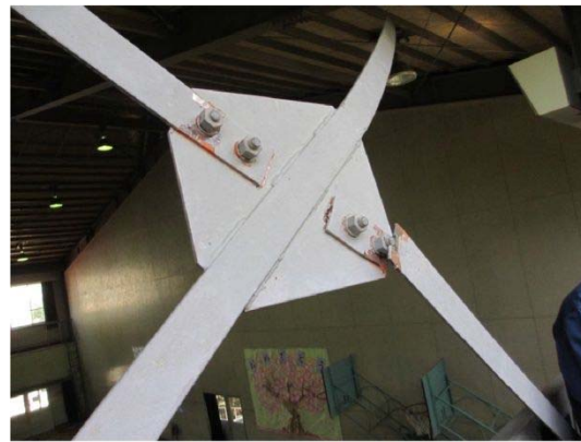
ブレース孔欠損部の破断
