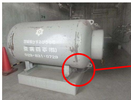
焼却炉用プロパンボンベ庫
