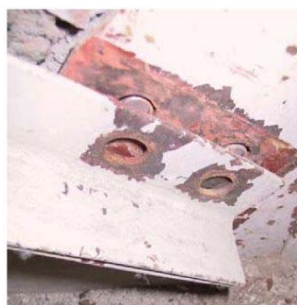
筋かい材ボルト破断
