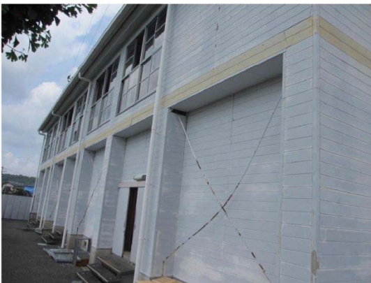
筋かい材の変形
