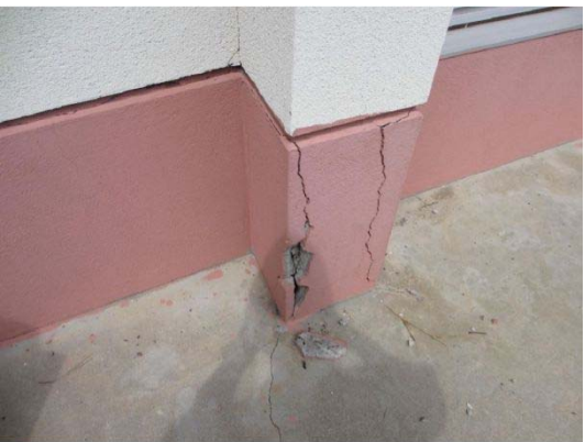
柱脚部コンクリートのひび割れ
