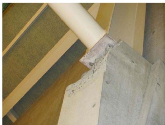
支承部コンクリート側方破壊
