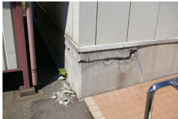
柱脚部コンクリートの割れ・剥落（長岡市）
