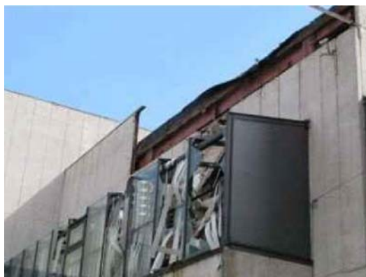
外装材の脱落，ガラス破損
