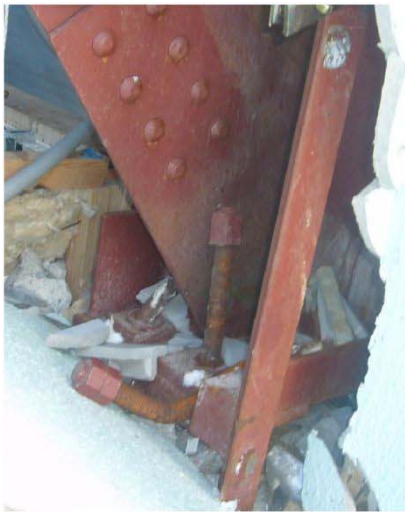
アンカーボルト引き抜け
