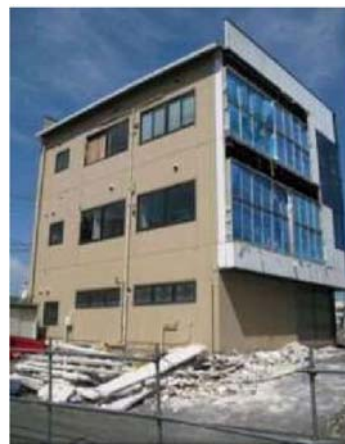
ALC パネルの脱落
