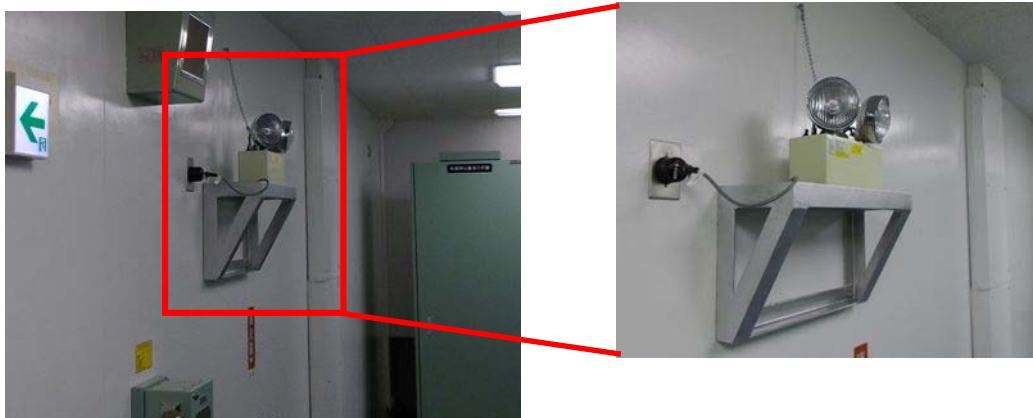
第2図 蓄電池内蔵型の照明
