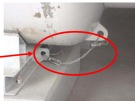
焼却炉用プロパンボンベ庫 プロパンボンベの固縛状況
