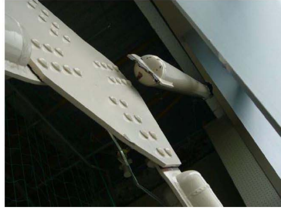
筋かい材プレート破断
