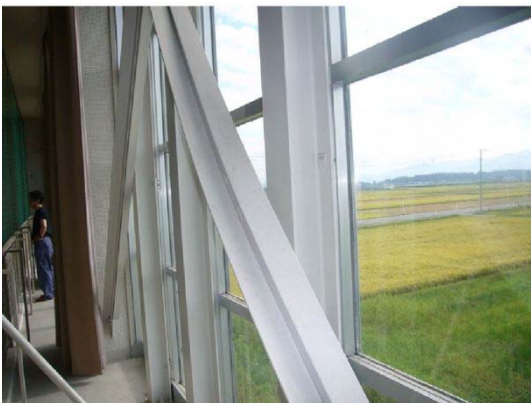
筋かい材の座屈（刈羽村）
