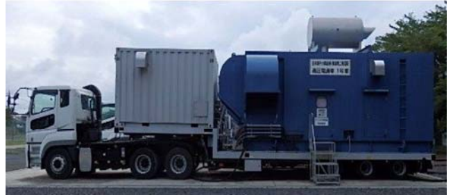
常設代替交流電源装置
