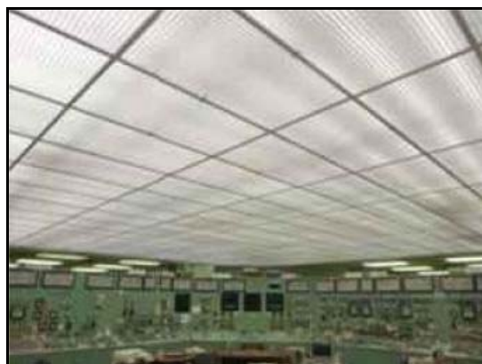
(通常点灯状態)
