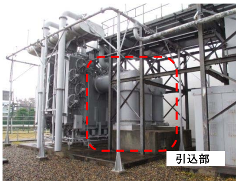
iii) 起動変圧器 (露出部無)
