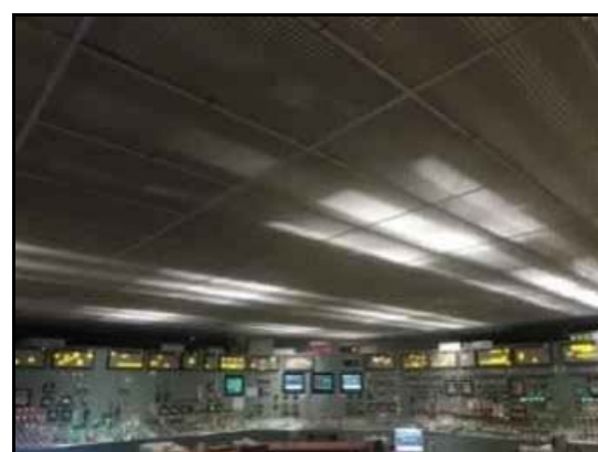
(直流非常灯点灯状態)
