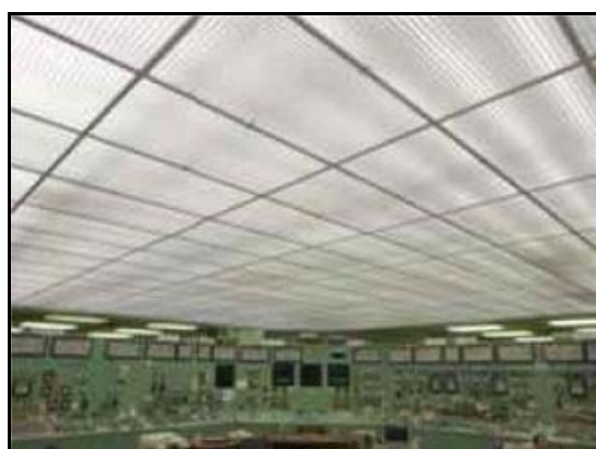
(通常点灯状態)
