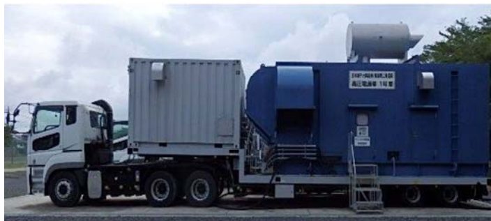
常設代替交流電源装置
