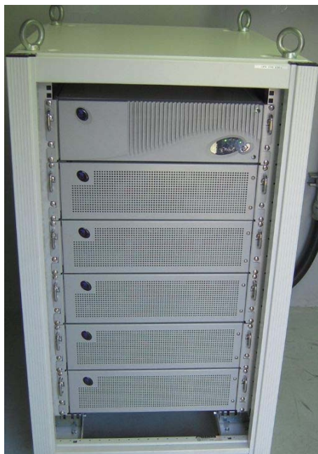
無停電電源装置
