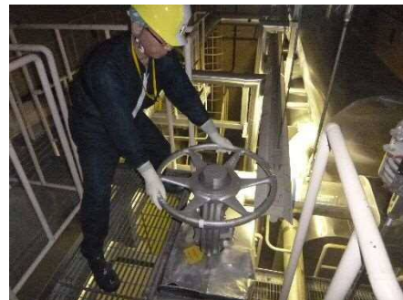
原子炉冷却材浄化系 再生熱交換器バイパス運転操作 （原子炉冷却材浄化系再生熱交換器バイパス弁）
