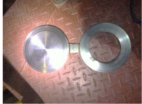
連絡配管閉止フランジ
