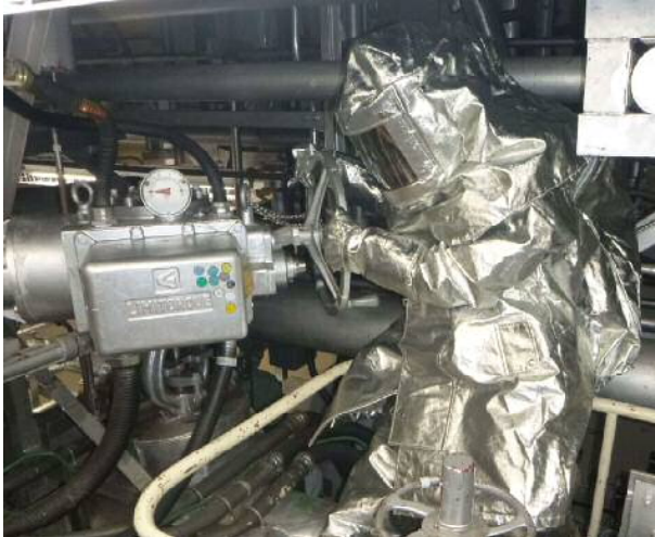
原子炉隔離時冷却系 起動操作
