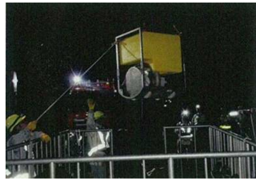
夜間での送水訓練（ポンプ設置）
