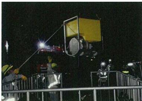
夜間での送水訓練（ポンプ設置）
