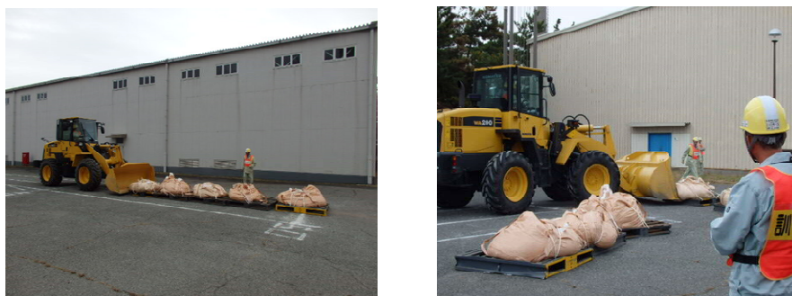
第 8-4 図 がれき撤去検証の写真
