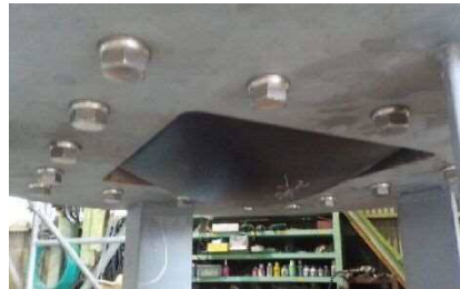
漏水試験時の状況（0.17MPa10分後）
