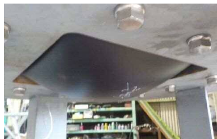
漏水試験時の状況（0.21MPa10分後）
