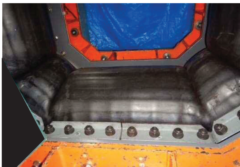
底版 (漏えいなし)
