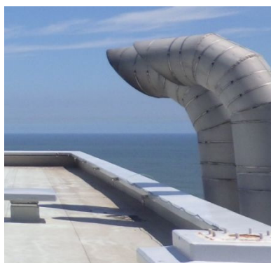
図 2.3-4 ディーゼル発電機 排気管
