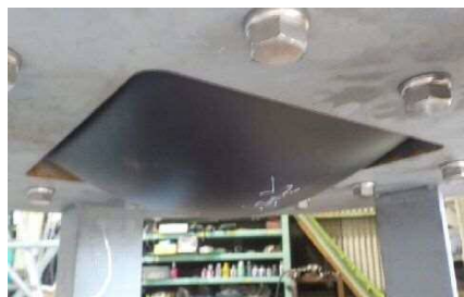
漏水試験時の状況（0.21MPa10分後）
