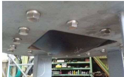
漏水試験時の状況（0.17MPa10分後）
