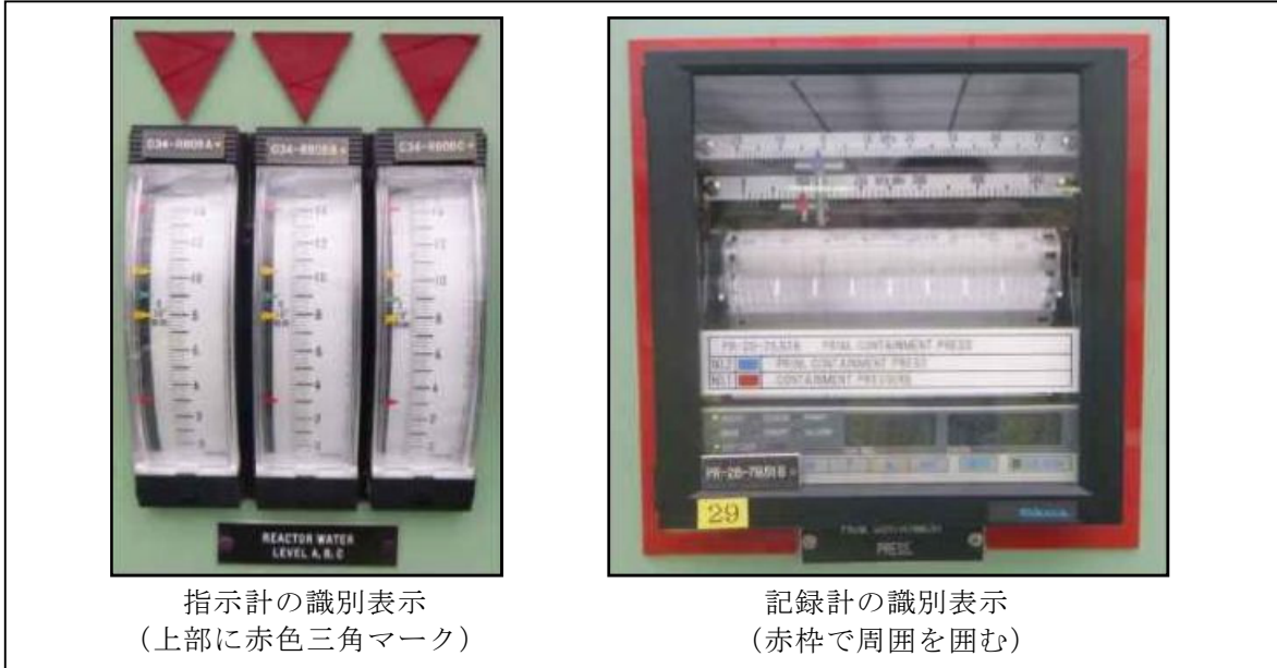
第 2.1-6 図 重要指示計等の識別表示 (例)
