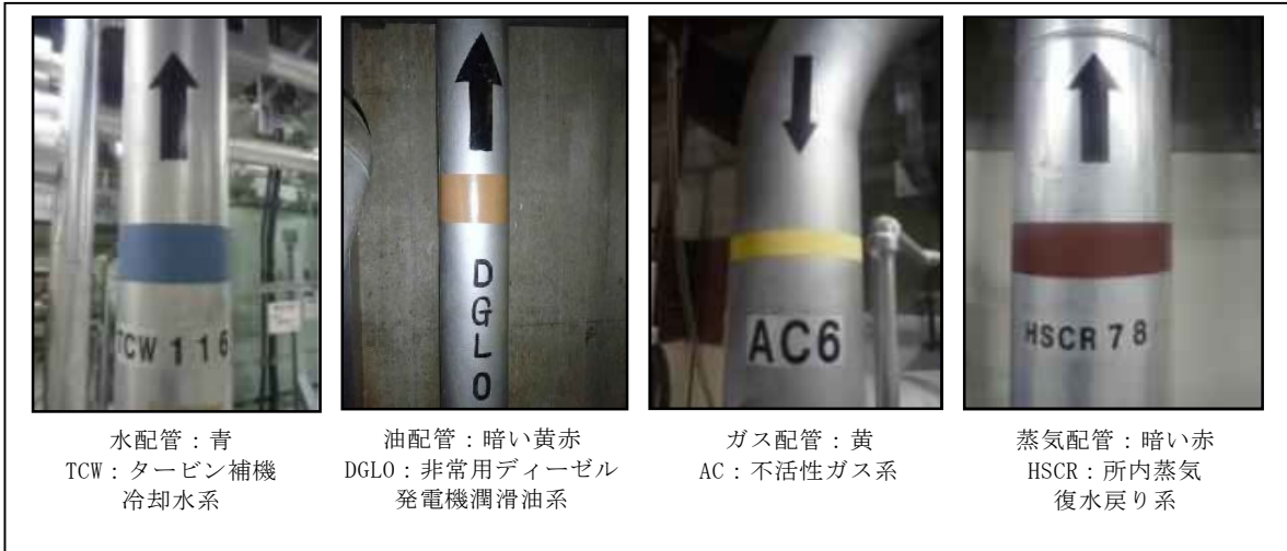
第 2.2-2 図 配管の識別管理（例）
