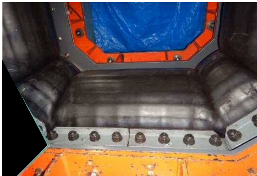
底版 (漏えいなし)
