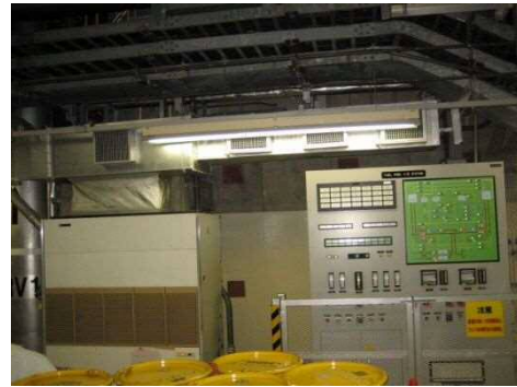
21 No. 22 の扉と同時に開放状態となった場合, 建屋内部に通風し, 防護対象設備に影響を与える恐れがある (非常用ガス処理系設備, 非常用ガス再循環系設備)
