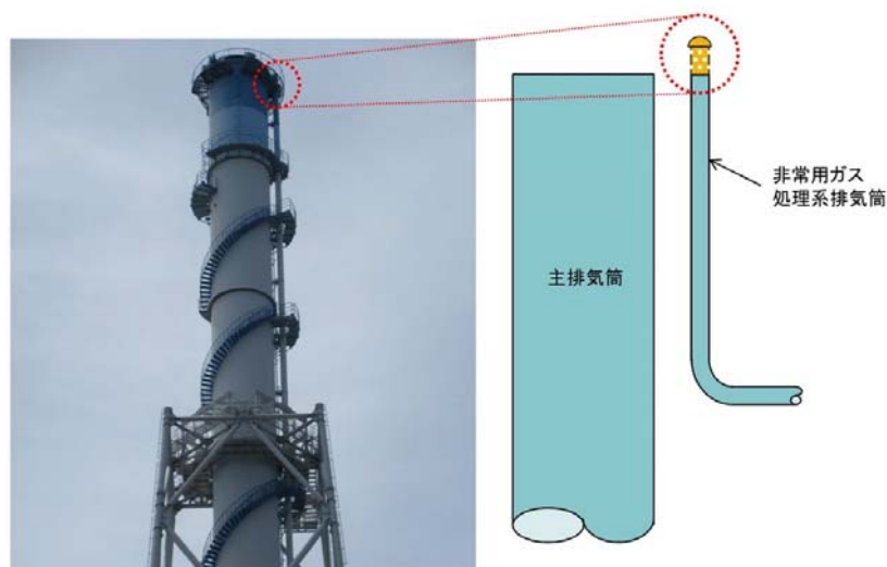
図 1-10 非常用ガス処理系排気筒
