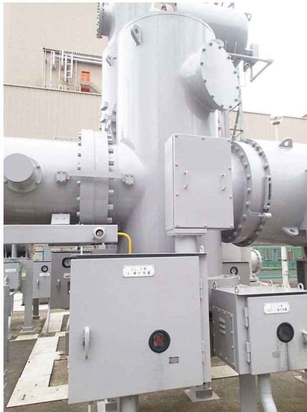
図 1-26 断路器の外観（開閉状態確認イメージ）
